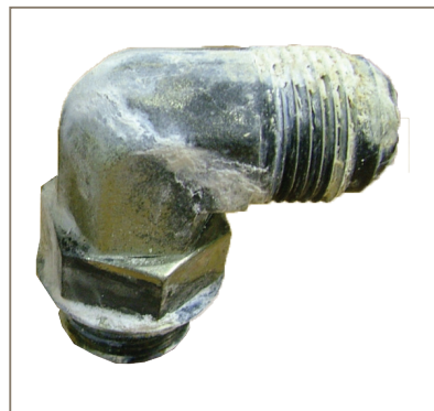
图 5：钢制硬管接头上的锌氧化
